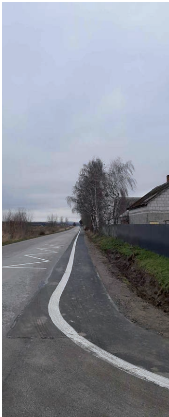
Przebudowa drogi powiatowej na odcinku Zamiany - Szarowola wraz z budową bezpiecznego utwardzonego pobocza - 135 249,66 zł
