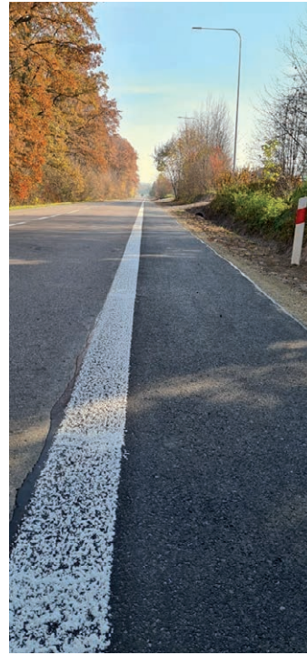
Remont i budowa bezpiecznego utwardzonego pobocza przy drodze powiatowej na odcinku Chorążanka - Przewłoka - 498 611,27 zł
